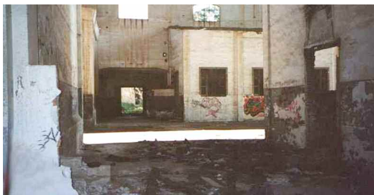
Nelle foto in basso e a destra, l'interno dell'edificio nell'incuria.
